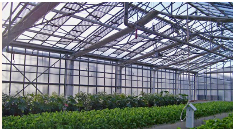
Foto 2 La serra fotovoltaica realizzata con moduli CIS composti da celle rettangolari distanti tra loro 5 cm
