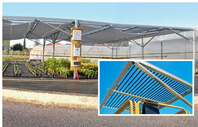
Foto 3 L'ombraio fotovoltaico realizzato presso il Cersaa con i moduli prodotti da Solyndra aventi celle CIGS poste in cilindrici distanti tra loro 8 cm (vedi dettaglio )
